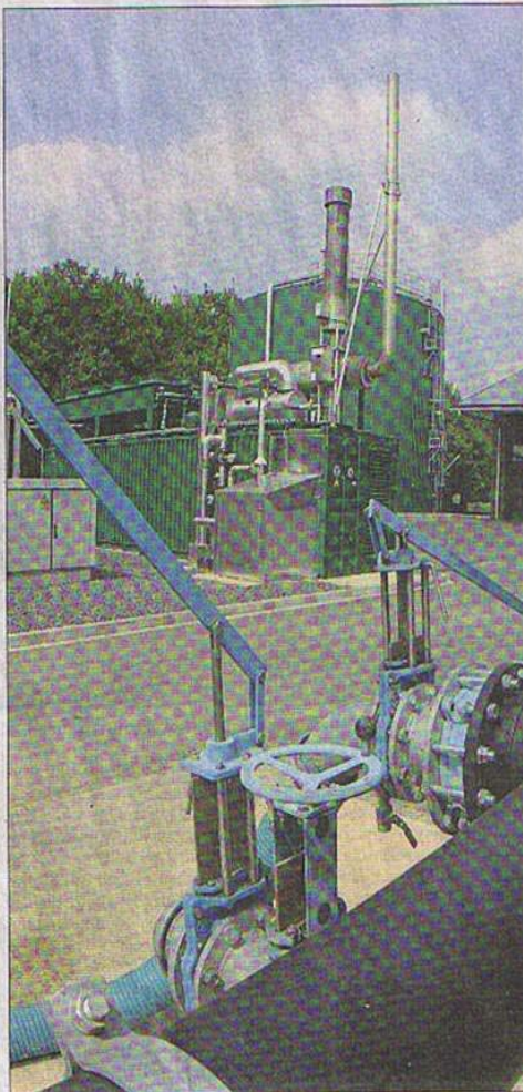
Die Biogasanlage des Odendorfer Landwirtes.
